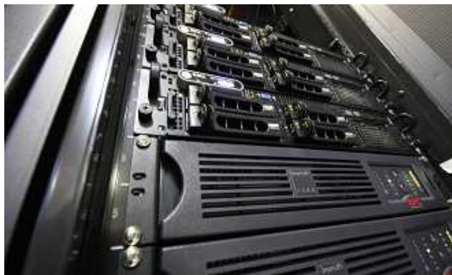
ベンダーの技術が結集された映像送信設備
